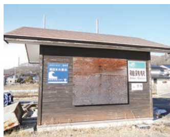
磯崎駅に設置された浸水表示板 (平成29年1月)
