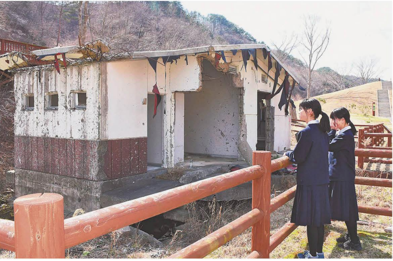
むき出しになった基礎と破壊されたコンクリート壁が津波の威力を物語る中の浜キャンプ場のトイレ・シャワー室―宮古市崎山
