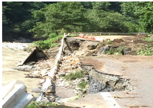
平成28年8月 台風10号 道路崩落(江繋)
