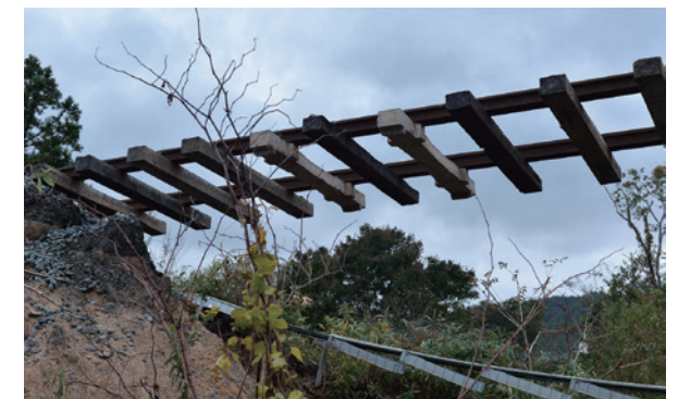
令和元年東日本台風では、交通にも大きなひがいが出ました。路盤が流されてしまった三陸鉄道のせんろのようす
