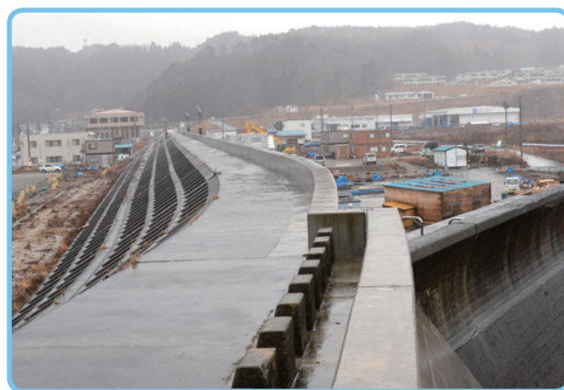
震災遺構「田老防潮堤」。おくにつづくのが第1防潮堤、右につづくのがこわれた第2防潮堤
