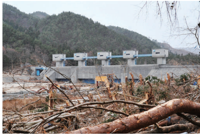
被災直後の普代水門
