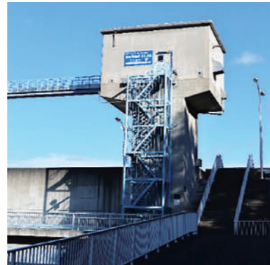
普代水門。高さ15.5メートルの堰堤のさらに上に設けられた第5機械室には「津波到達高」の表示
