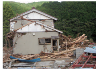
土石流の被害
