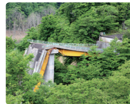
岸が移動して橋をあっぱくし、ほぼ直角にくずれた橋
