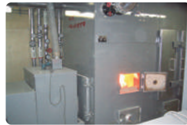
ペレットボイラー
