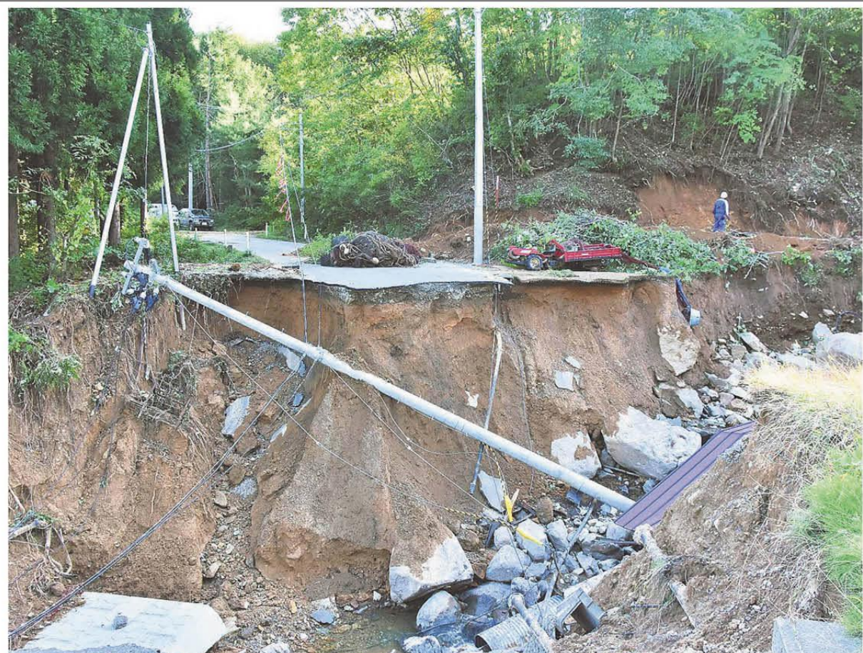
台風19号の大雨で崩落した市道。仲組地区(手前)の孤立が続いている=16日午後2時20分、宮古市重茂
