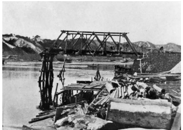
【写真 39】 宮古町（津浪に押し上げられた船のために破損した宮古橋）【中央気象台】
